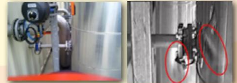
Ex fuite bride sur réseau biogaz
