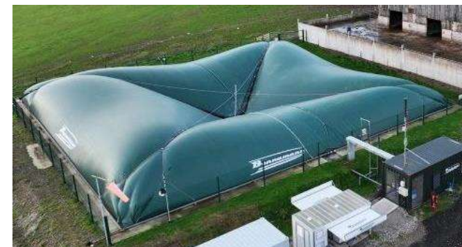
Bâche sur nouvelle lagune (collecte + stockage)
