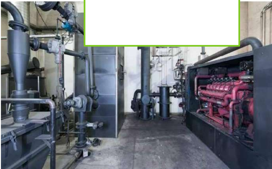
Wegscheid – Allemagne (2009) Première installation 133 kWe & 260 kWth
