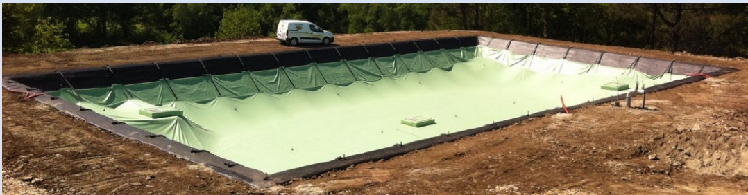
Photo 13 : Citerne souple semi-enterrée en pointe de diamant inversée (Source : Labaronne-Citaf).
