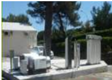
Station GNV d'Aix-en-Provence
