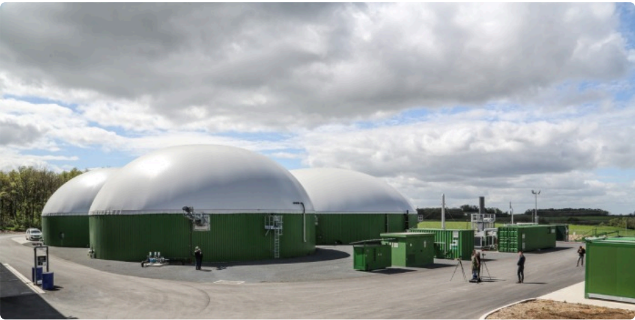
Installation de méthanisation (Source : ADEME)
