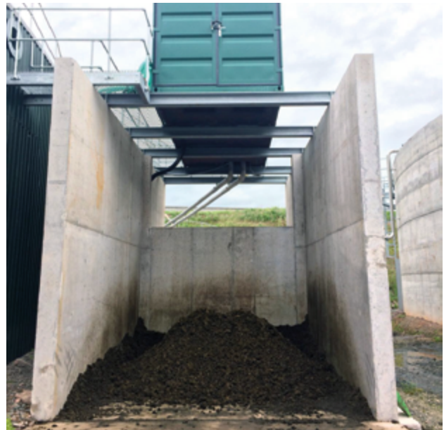
Séparation de phase de digestat brut
