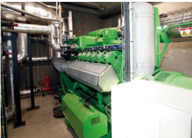
Unité de cogénération du biogaz brut prétraité
