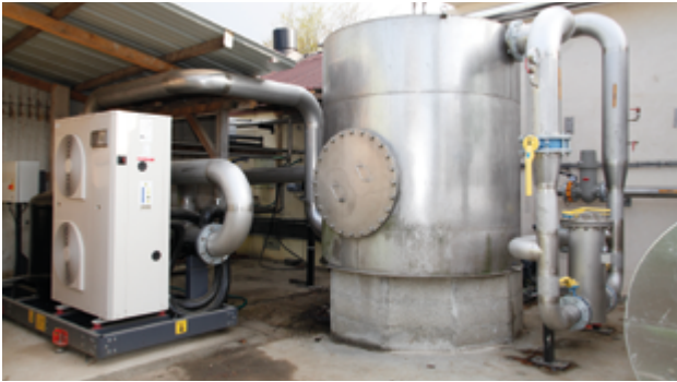
Unité de prétraitement du biogaz brut
