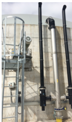
Soupape de sécurité hydraulique avec rejet de biogaz déporté
