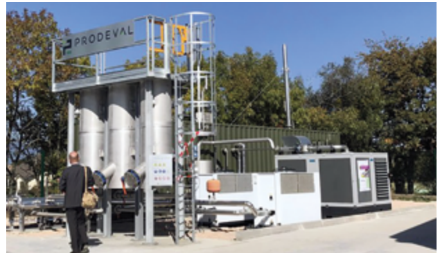
Unité d'épuration du biogaz brut prétraité
